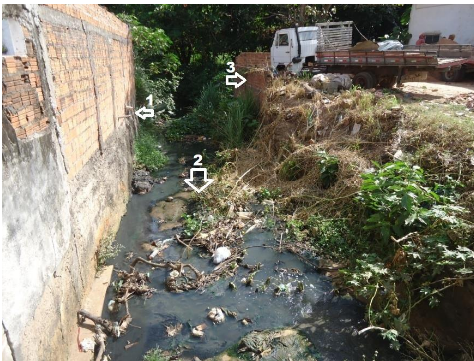
Foto 2 - Canal assoreado pelo acúmulo de sedimentos e resíduos sólidos – 06/2017
