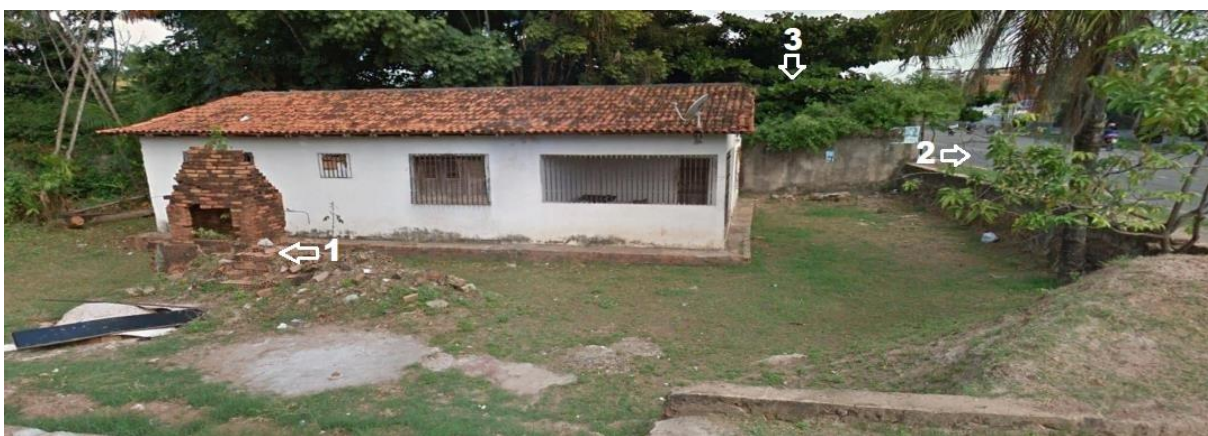
Foto 6 - Moradia atingida por inundação, Rua João Alberto
