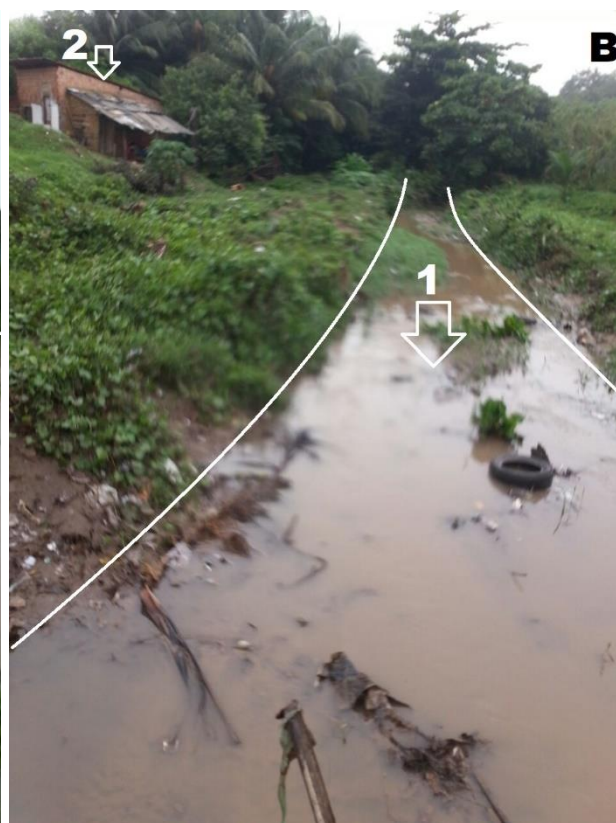
Foto 5B - Canal fluvial na Rua Projetada ap s evento de inunda o (08/02/18)
