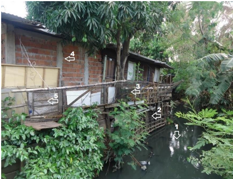
Foto 7 - Habitações construídas no leito do rio, Rua São Carmelo – Pirapora
