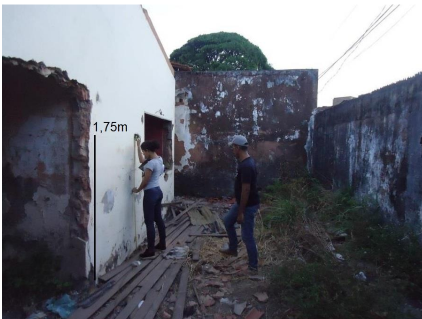
Foto 14 - Marcas de inundação na parede da residência abandonada
