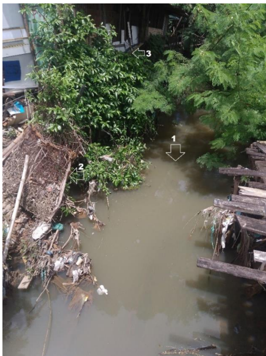
Foto 8 - Destruição da ponte no período chuvoso
