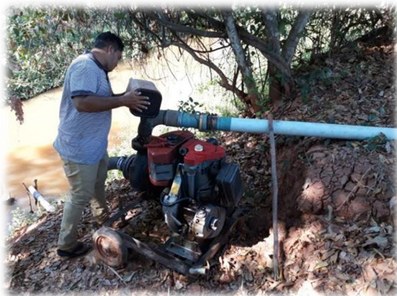
Figura 12 – Motor bomba instalado no rio Gurguéia
