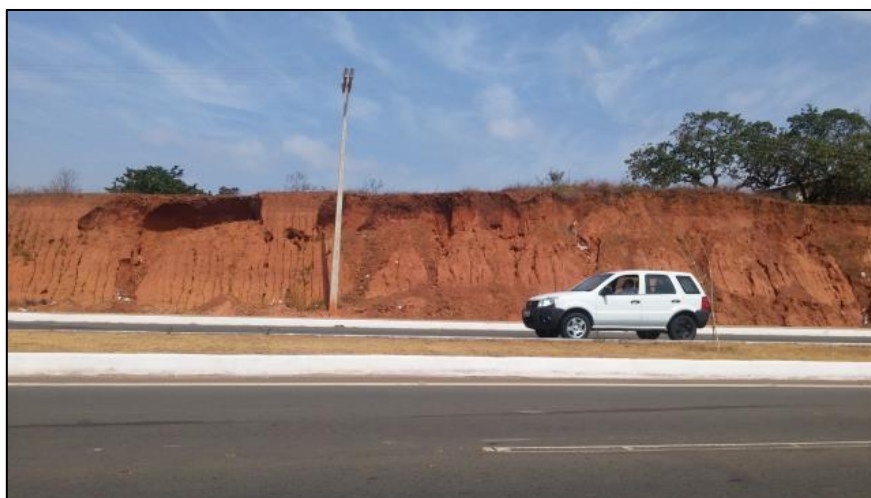
Figura 71 - Talude em corte de estrada com rede de ravinas próximo ao Ponto 5
