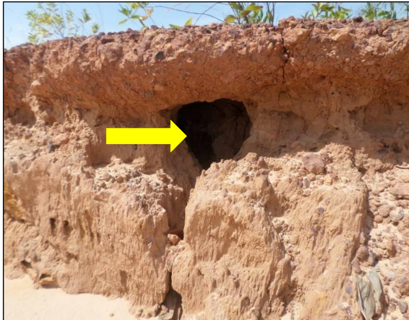
Figura 57 - Duto no interior da voçoroca
