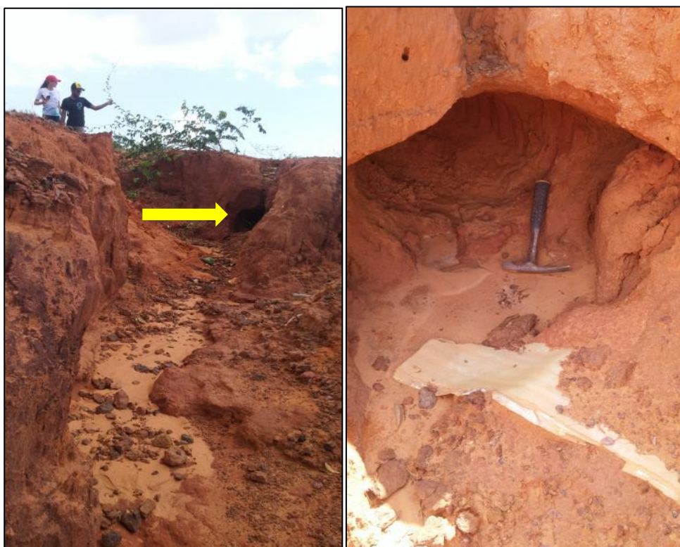
Figura 62 - Direção do Fluxo de escoamento e presença de alcovas de regressão
