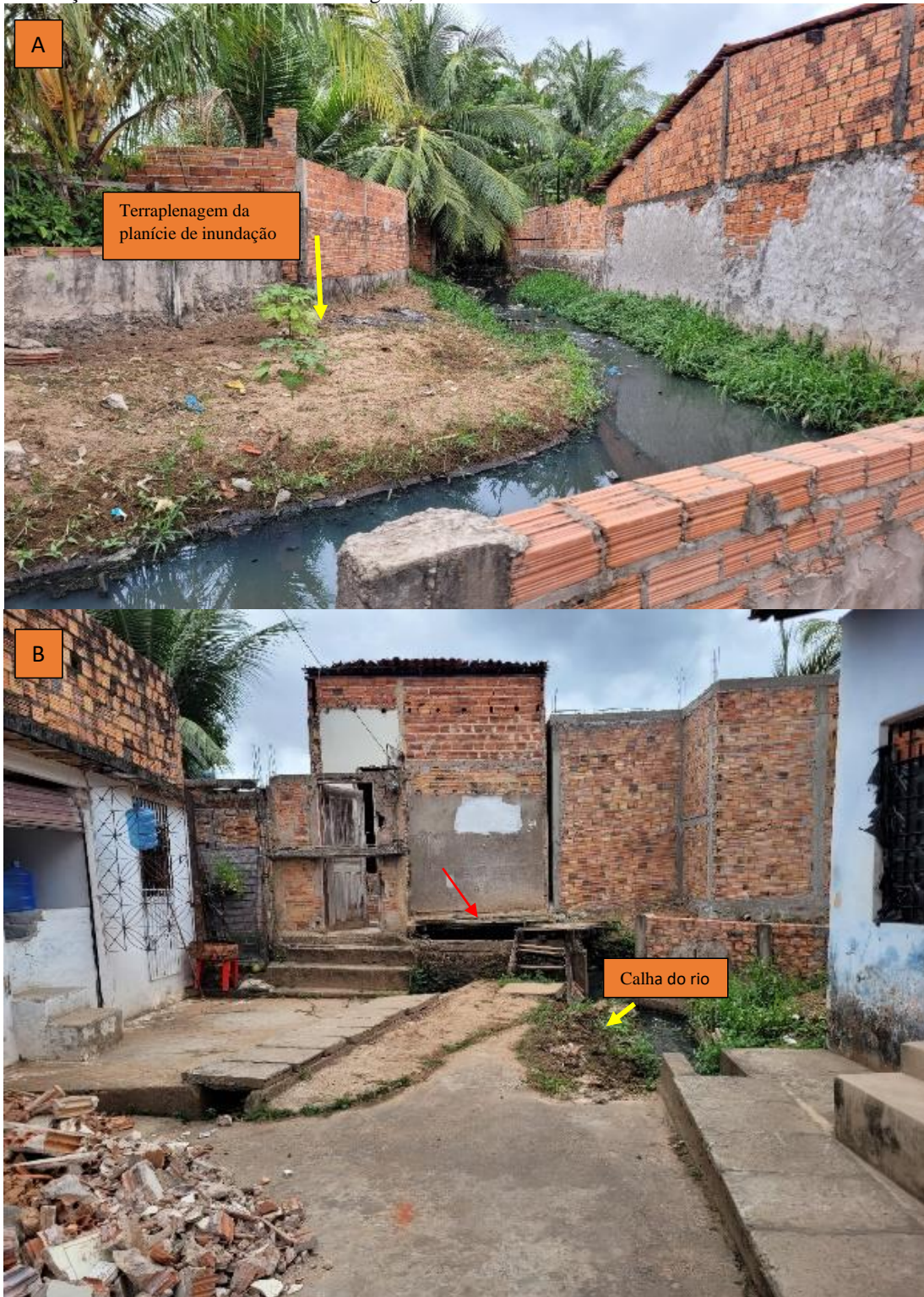
Figura 38 - (A) Aterro das planícies de inundação com materiais úrbicos e construção de casas nas margens do rio, Vila Ivar Saldanha; (B) Aterro das planícies de inundação com materiais úrbicos e construção de casas sob o canal de drenagem, Vila Ivar Saldanha
