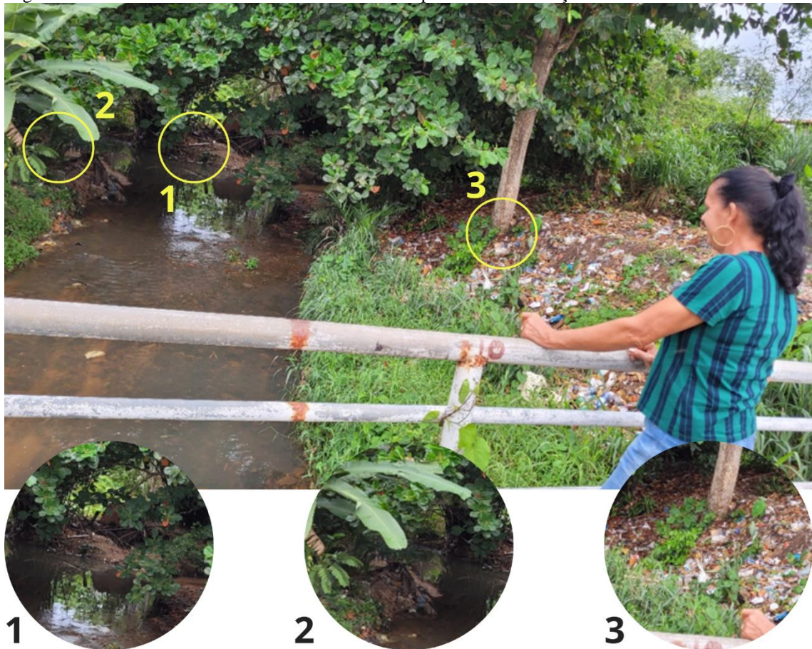
Figura 49 - Rio Assoreado e materiais de bota-fora na planície de inundação no Bairro Anil
