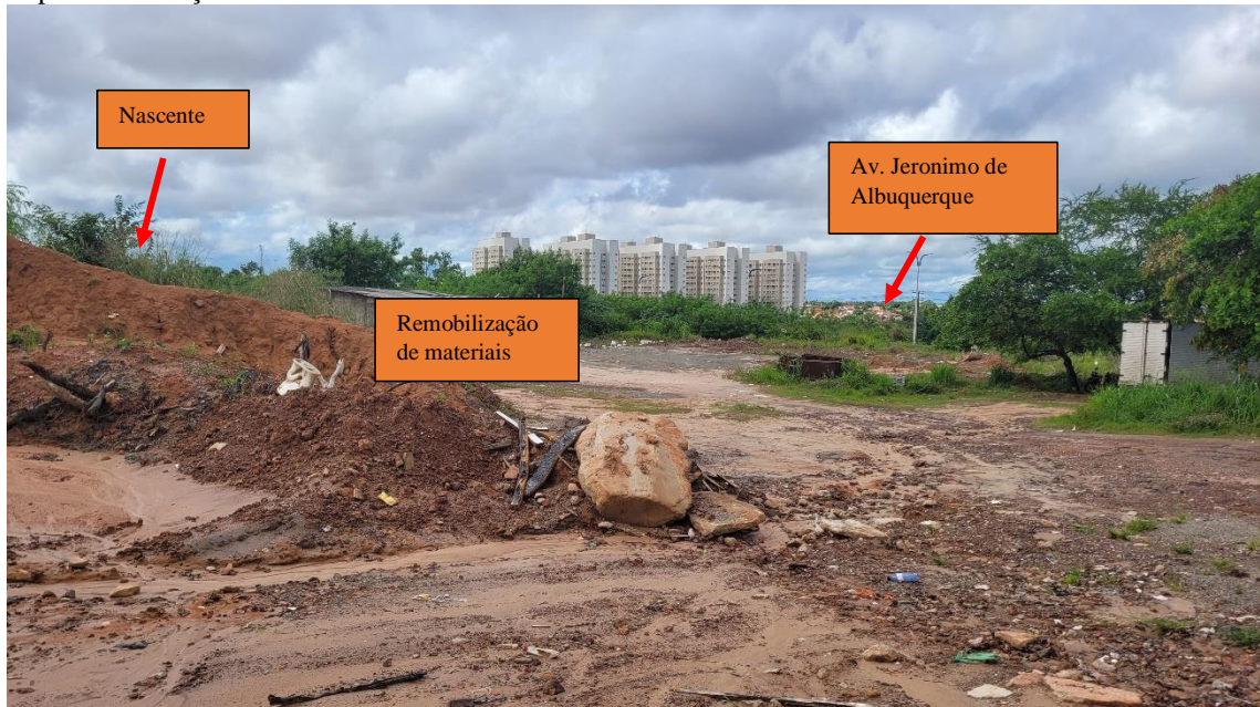
Figura 43 – Área de recarga hídrica passando por um processo de aterramento com materiais gárbicos e impermeabilização do solo
