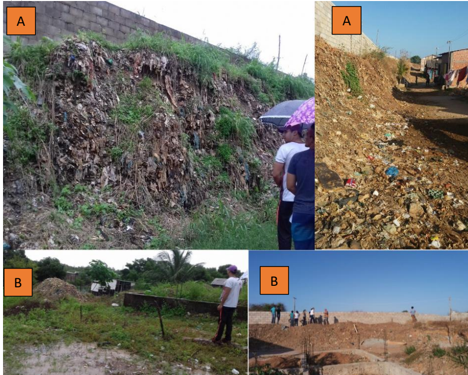
Figura 27 - Afloramento de substratos gárbicos do aterro na Comunidade do Jaracaty (A); início do aterro para a construção de casas de alvenaria com materiais gárbicos advindos do antigo lixão da cidade (seta amarela) sobre a planície tecnogênica mista (B)
