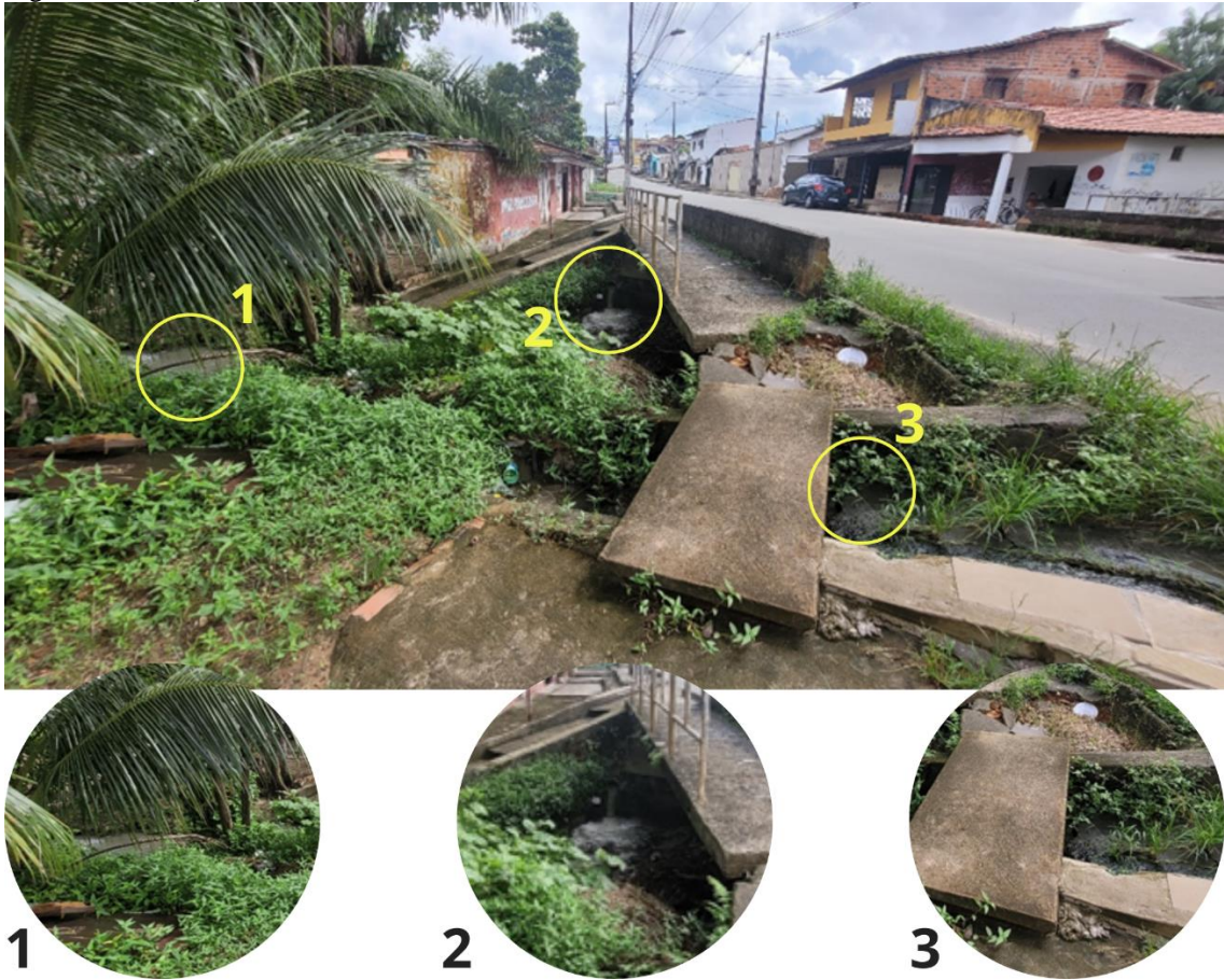
Figura 11 – Lançamento de efluentes in natura em um dos afluentes do rio Anil no bairro do Anil
