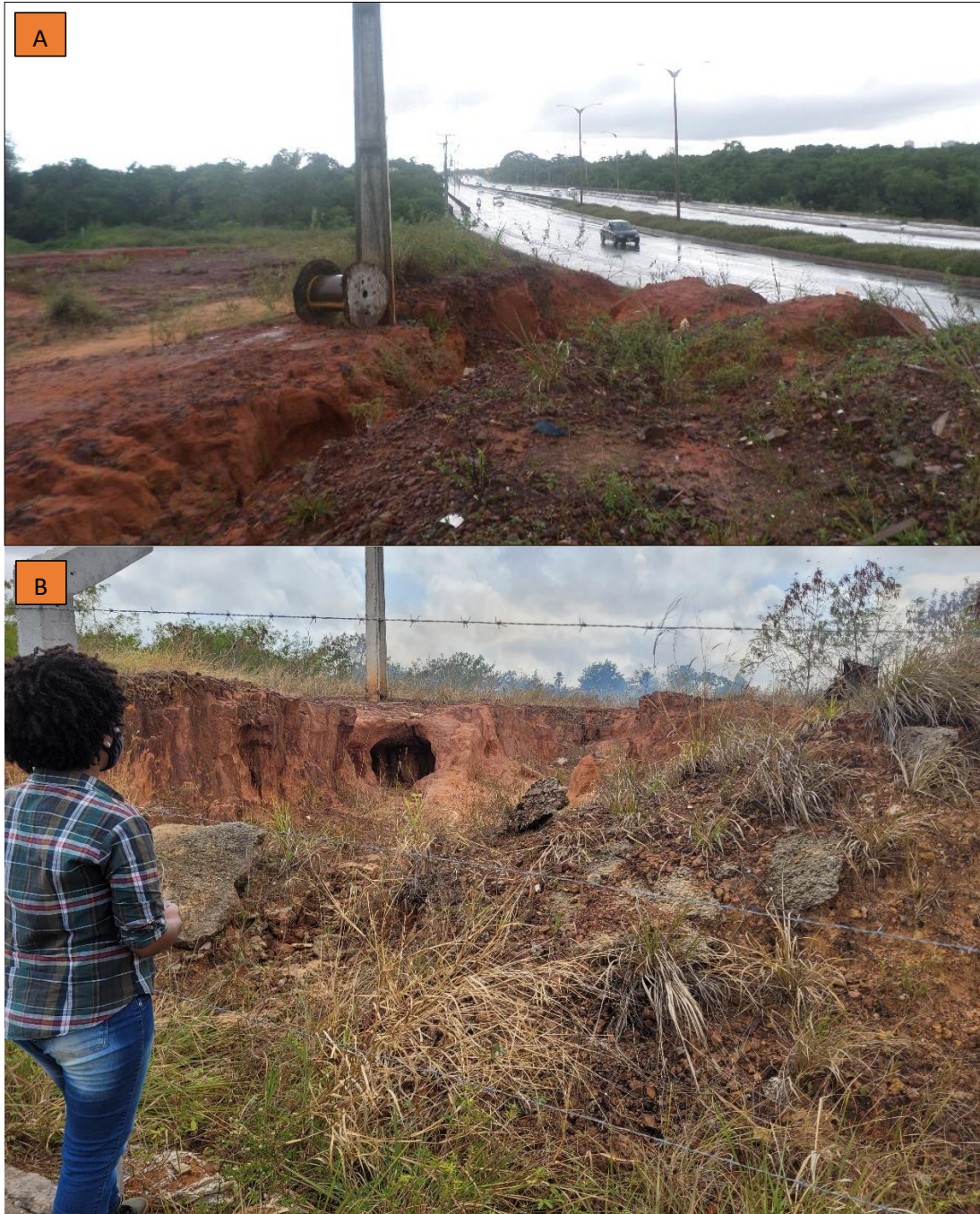
Figura 34 – (A) Terreno com feições induzidas, apresentando sulcos às margens da Via Expressa (2018); (B) Terreno com feições induzidas, apresentando erosão interna ( pinping ) às margens da Via Expressa (2021)
