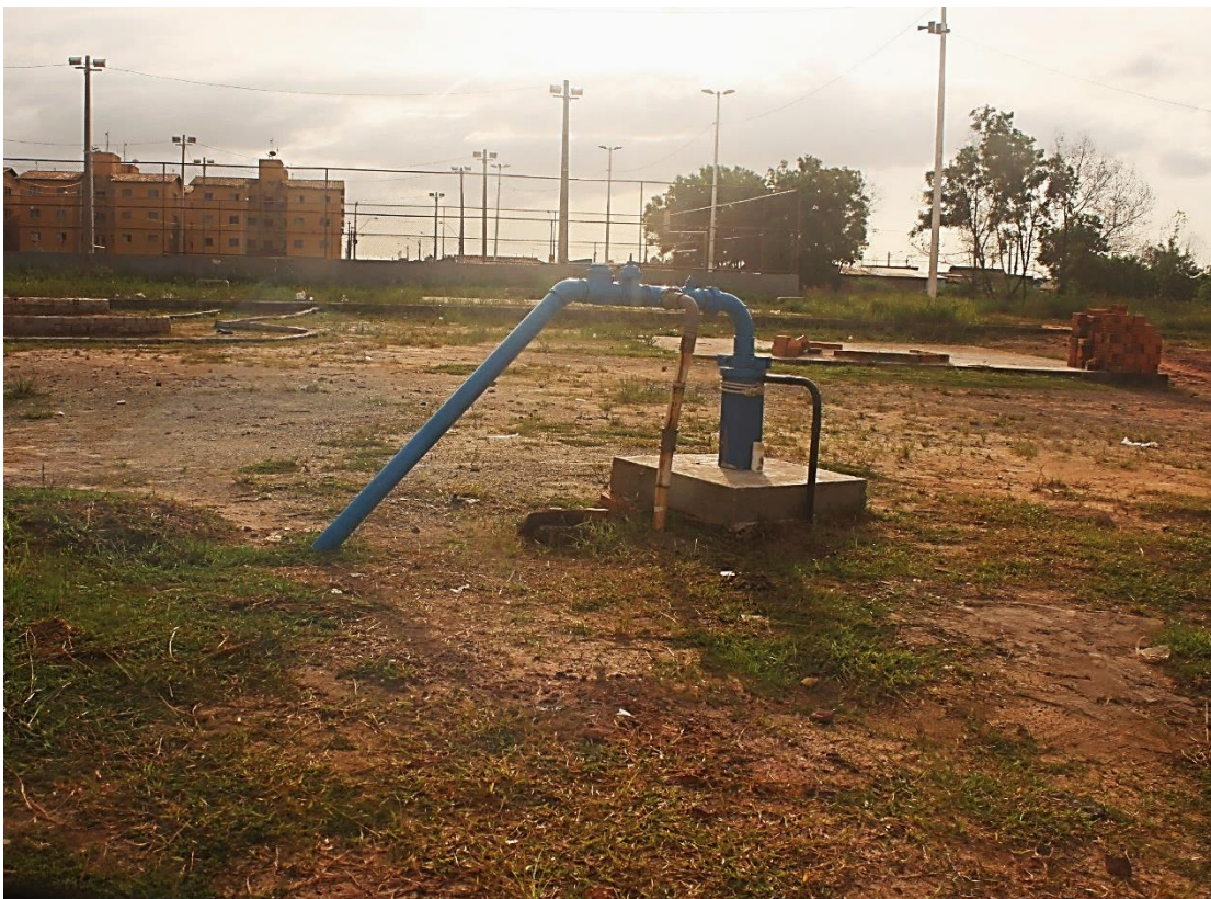
Figura 32 - Poço que atende o Residencial Ribeira, em São Luís - MA
