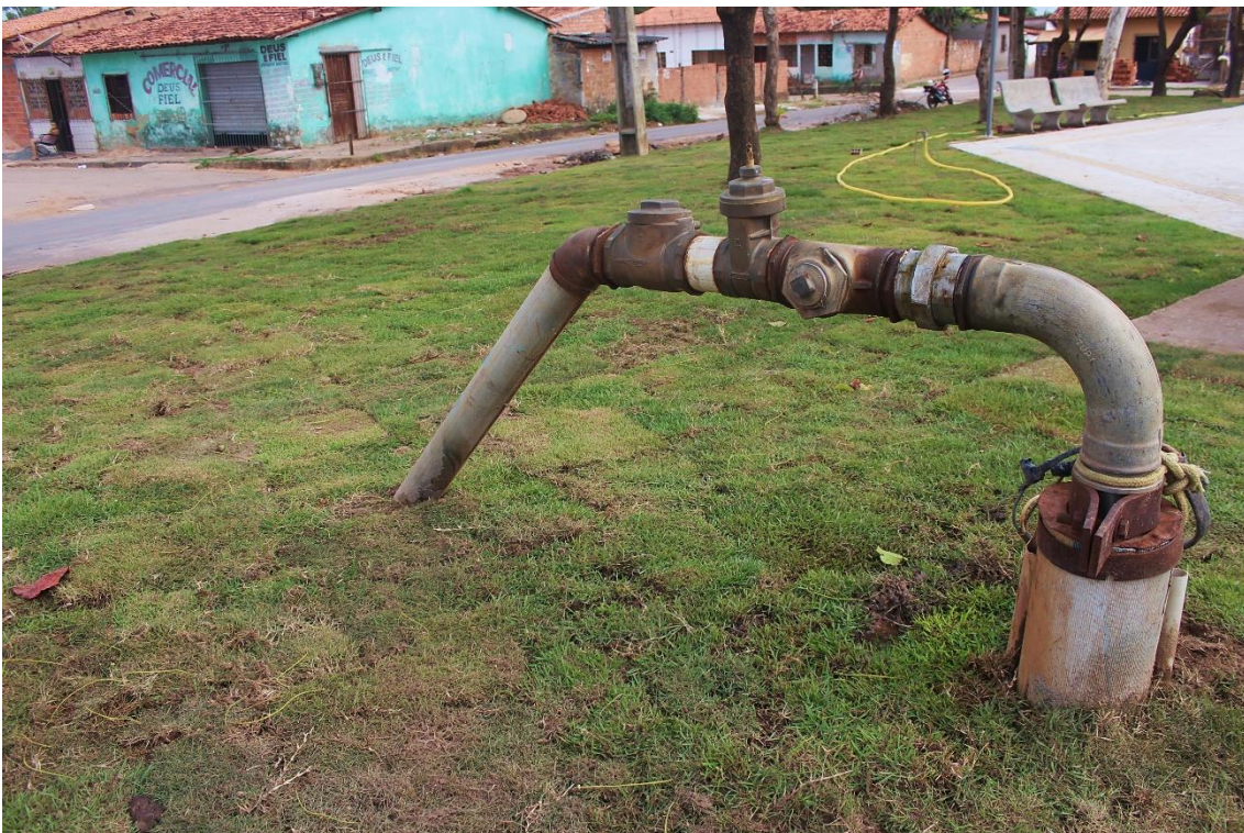
Figura 34 - Poço da CAEMA localizado no bairro São Raimundo, em São Luís - MA.
