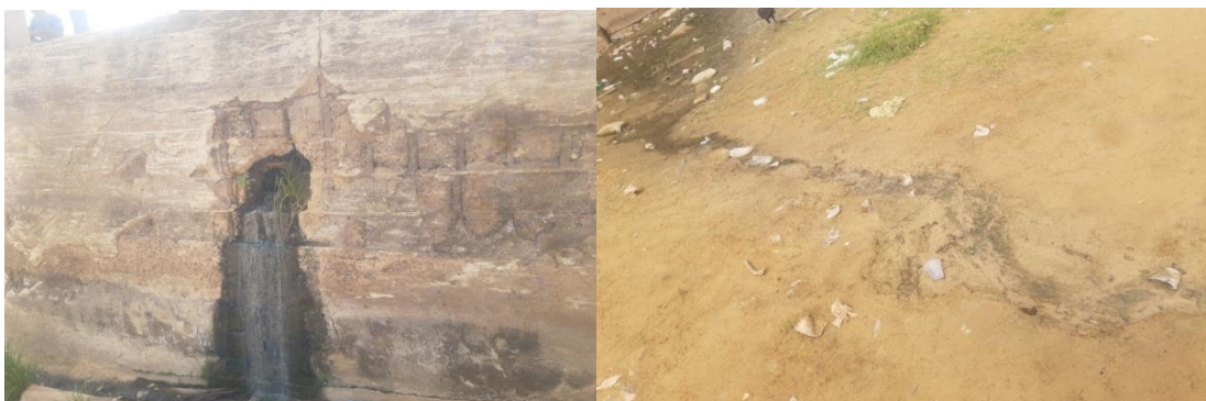
Figura 23- Esgotos In Natura e Resíduos Sólidos direto no Rio
