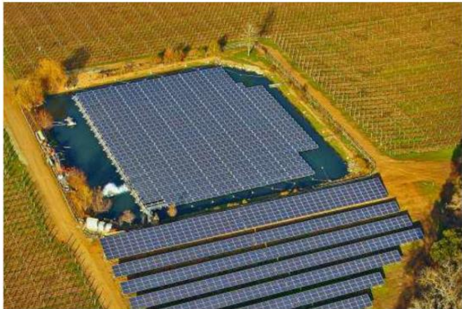
Figura 16 - Painel fotovoltaico flutuante
