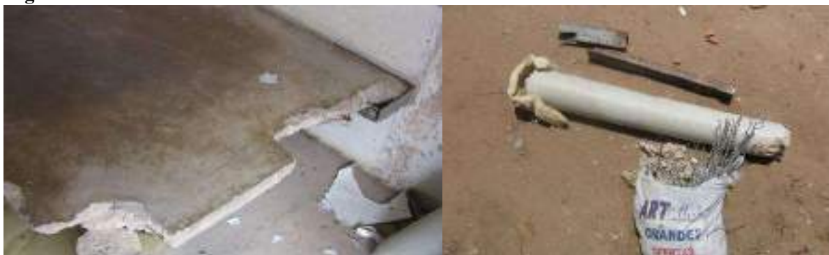
Figura 10 – Cama de concreto avariada
