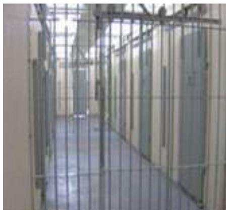
Figura 4 - Entrada da cela sem adaptação contra o descarrilhamento
