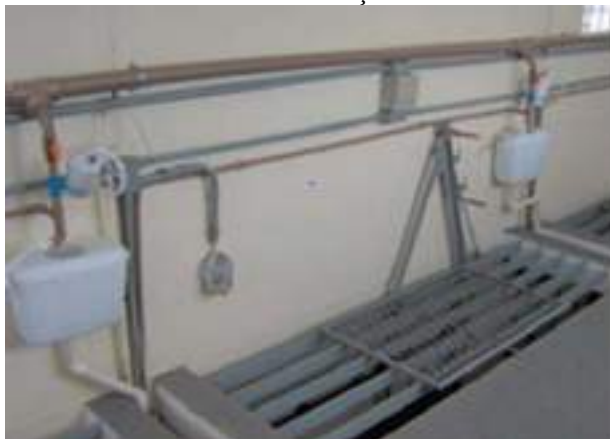
Figura 1 – Infraestrutura de instalações sanitárias e hidráulicas aéreas
