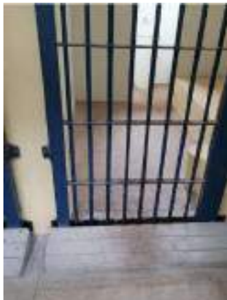
Figura 3 - Base de concreto contra descarrilamento da grade da cela
