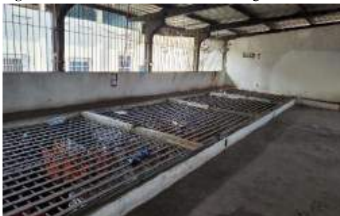
Figura 32 – UPSL 2 e 3 – teto da cela era grade
