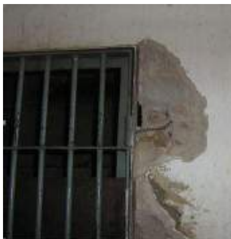
Figura 3 - Grades da UPSL-4 avariadas
