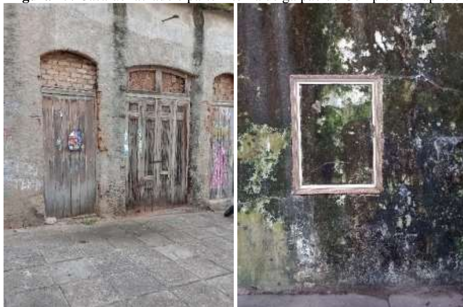
Figura 25: Casarão lacrado e parte interna de galpão do Complexo Trapiche
