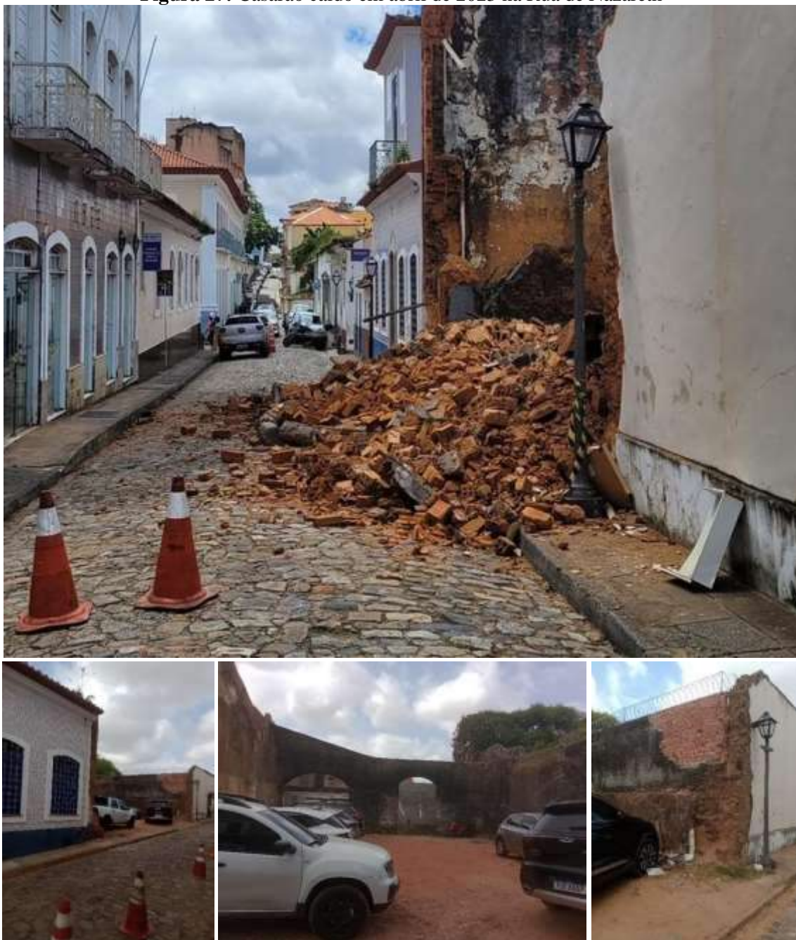
Figura 27: Casarão caído em abril de 2023 na Rua de Nazareth
