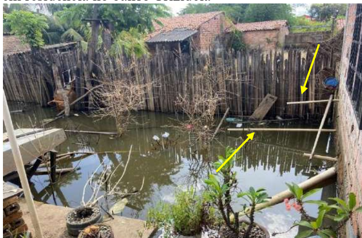
Figura 61 – Sistema de lançamento de esgoto improvisado, em residência no bairro Trizidela
