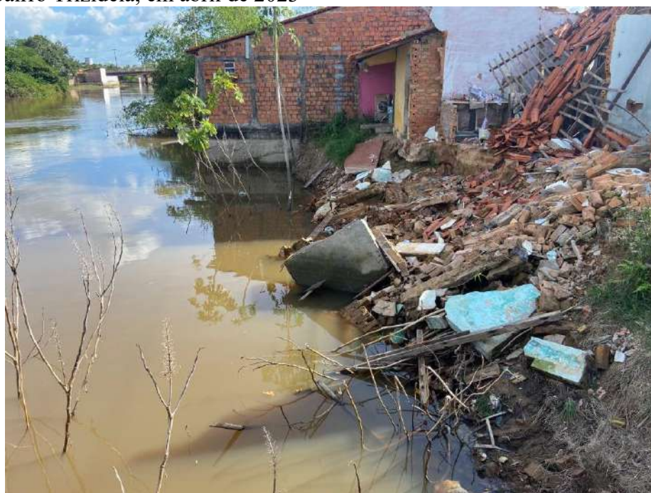
Figura 42 – Estrutura de residências comprometidas na Av. Jorge Mendonça, bairro Trizidela, em abril de 2023
