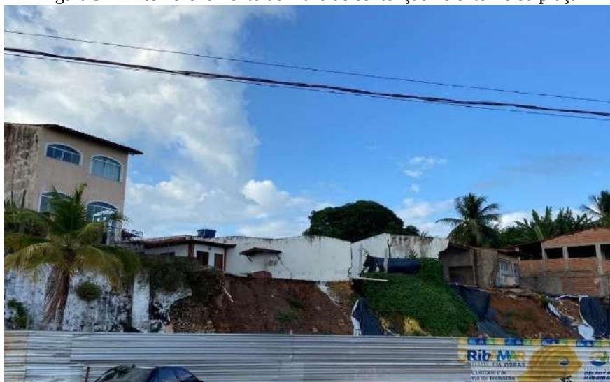
Figura 32 – Desmoronamento do muro de contenção no entorno da praça
