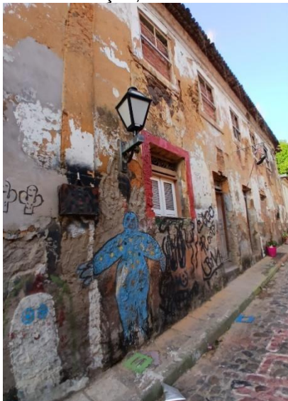
Imagem 2: Casarão em estado ruim de conservação, Rua da Palma
