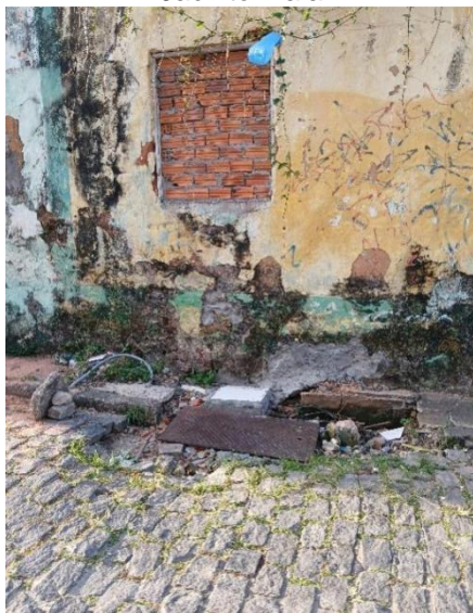
Imagem 51: Calçamento deteriorado na Rua Jacinto Maia
